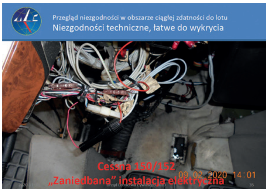
Fot. 7. Wisząca instalacja elektryczna
